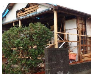
風で壁が吹き飛んだ家屋。飛んだ瓦や倒木が町内各地で見受けられ、被害の大きさを物語っていました
